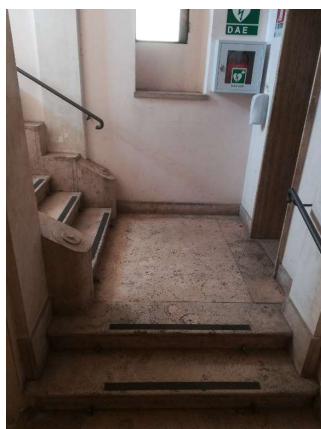
Fig. 15 – Palazzo Ossoli – dislivello pianerottolo sbarco ascensore piano terzo
